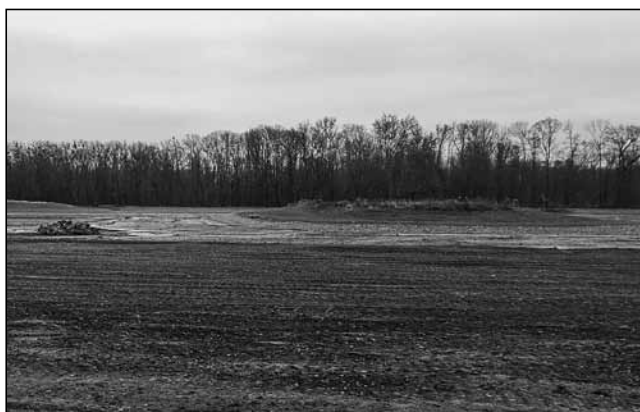
Stabilizace ostrovů v rybníku Bažantula proti rozplavování.
