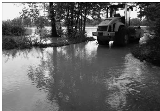
Podzimní povodeň 2020 přeplavila hráze některých rybníků, ke škodám na nově vybudovaném díle však nedošlo.
